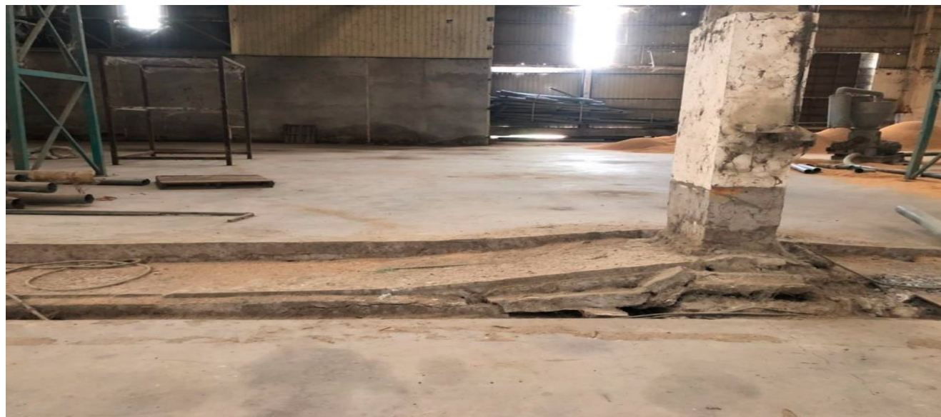
Nền hè sụt lún, hệ thống thoát nước phá hủy
